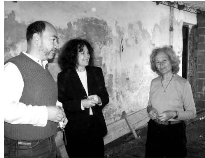
El arquitecto Gregorini con Norma y Estela Barbá observan las obras de remodelación.
